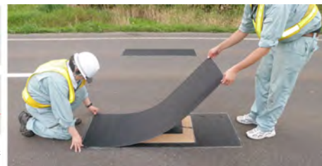
簡易型トラフィックカウンターの設置
